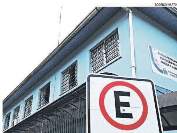
Processo previa alarme de incêndio e iluminação de emergência
