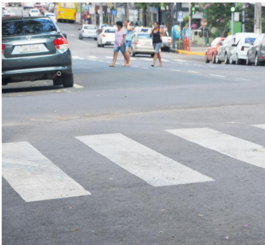
Na av. Benjamin Constant, próximo às esquinas com as ruas Tiradentes e Pinheiro Machado, pedestres se arriscam em
