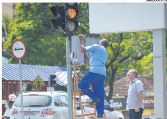
Problemas nos semáforos instalados na área central são recorrentes
