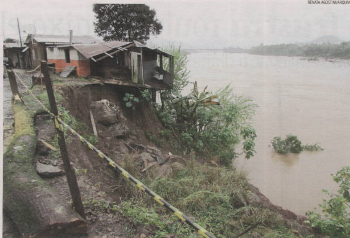
Casas e estradas estão comprometidas. Levantamento das áreas se inicia em 15 dias, com prazo de seis meses
