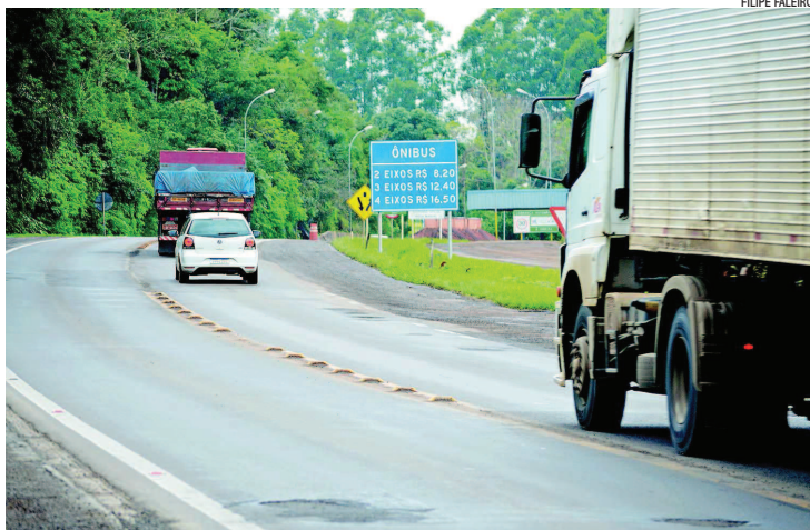
Na RSC-453, os buracos antecedem a chegada na praça de pedágio em Cruzeiro do Sul
