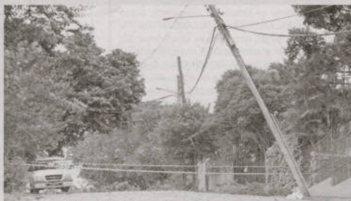
Parte da Rua Piauí foi interrompida, e poste ameaça cair
