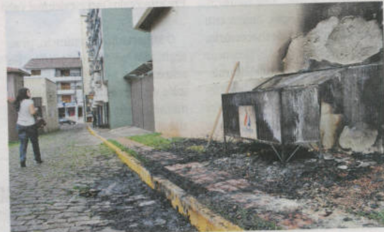
Fogo danificou a parede e quase alcançou um apartamento no primeiro andar
