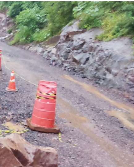
ro e Arroio do Meio na VRS-811
