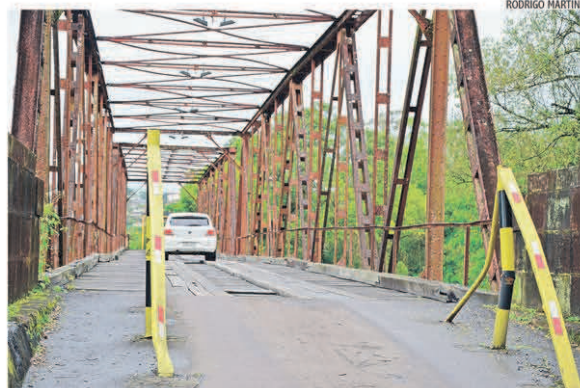
Ponte de Ferro apresenta problemas. Governo anuncia reformas na passagem
