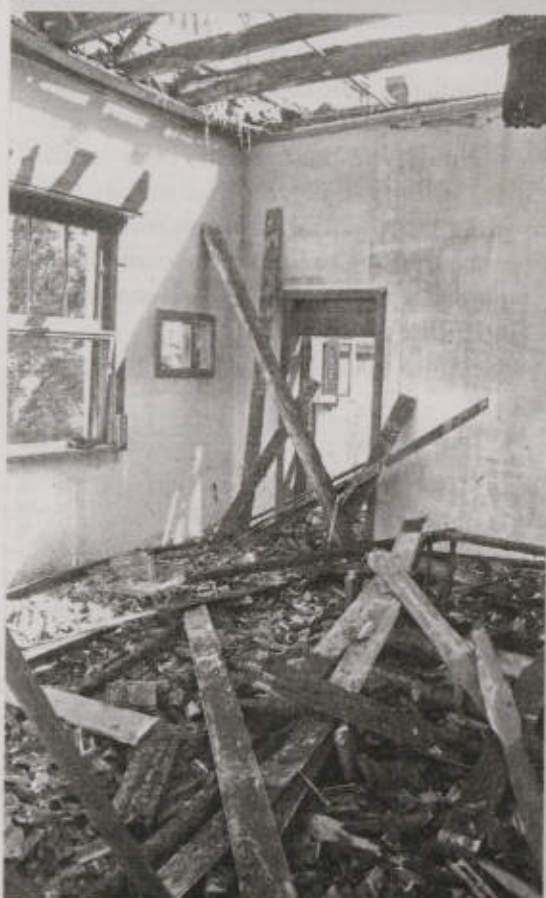
Incêndio danificou grande parte da estrutura interna
