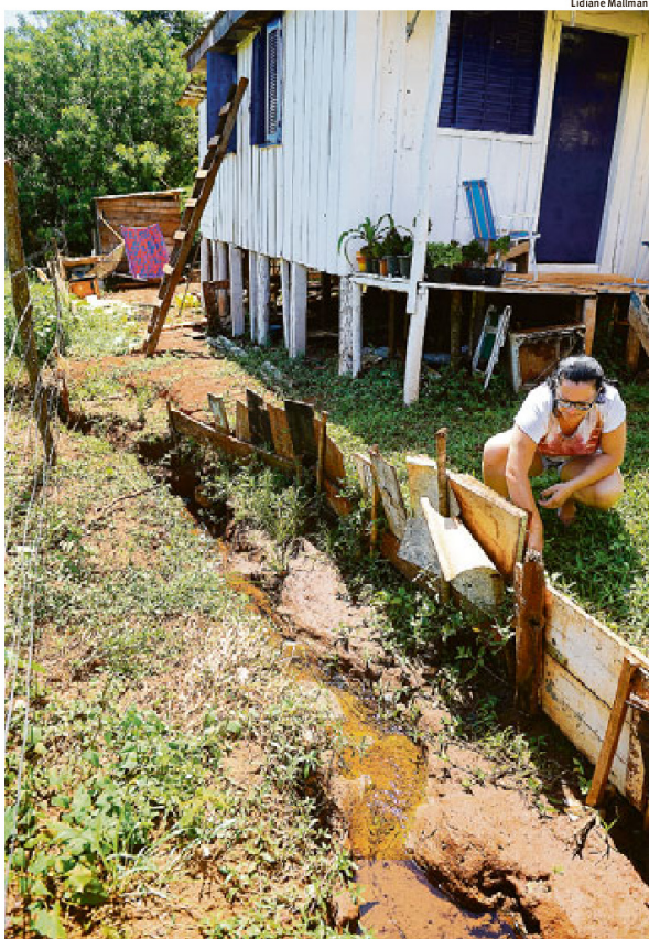
ESGOTO: Luci improvisa uma contenção para que não chegue na casa
