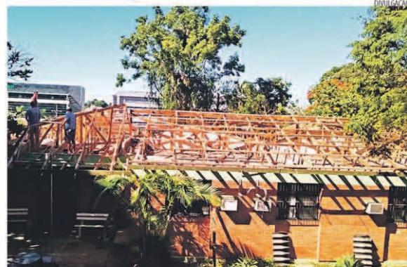
Temporal causou avarias na estrutura do posto do bairro São Cristóvão
