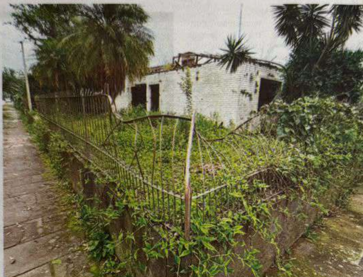
Em Lajeado, 335 proprietários de imóveis condenados foram notificados para demolição
