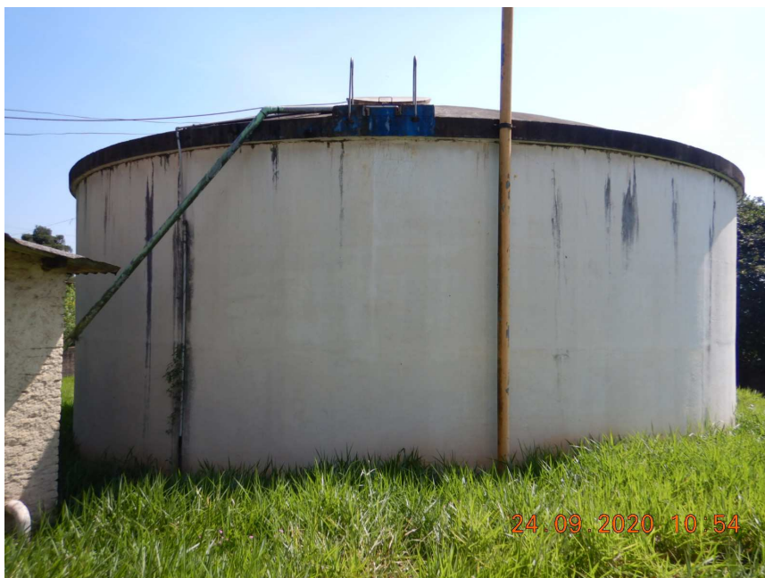
Figura 66: Centro de Reservaç o Conservas (Reservat rios R9A e R9B)
