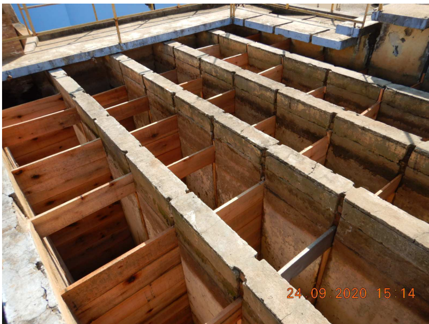
Figura 23: Sistema de floculação hidráulica
