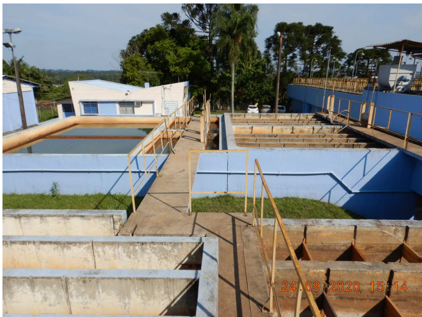
Figura 26: Visão geral do sistema de floculação e decantação
