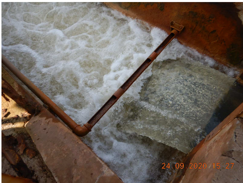
Figura 21: Zona de mistura dos produtos químicos para coagulação
