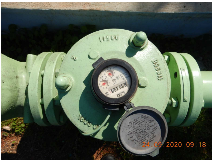
Figura 10: Macromedidor do poço LAJ 04
