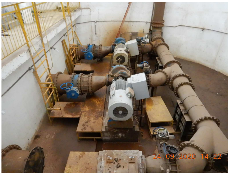
Figura 5: Conjunto motobomba do recalque novo
