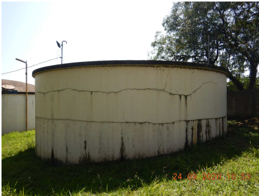
Figura 65: Centro de Reservaç o Conservas (Reservat rios R9A e R9B)
