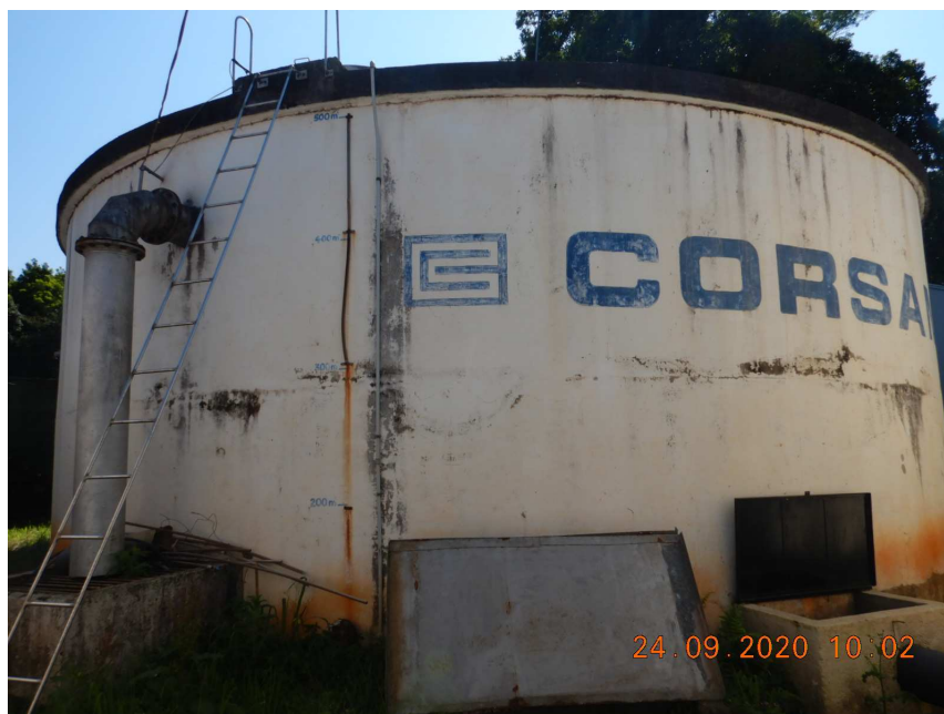
Figura 69: Reservatórios Montanha (Reservatórios R15A e R15B)
