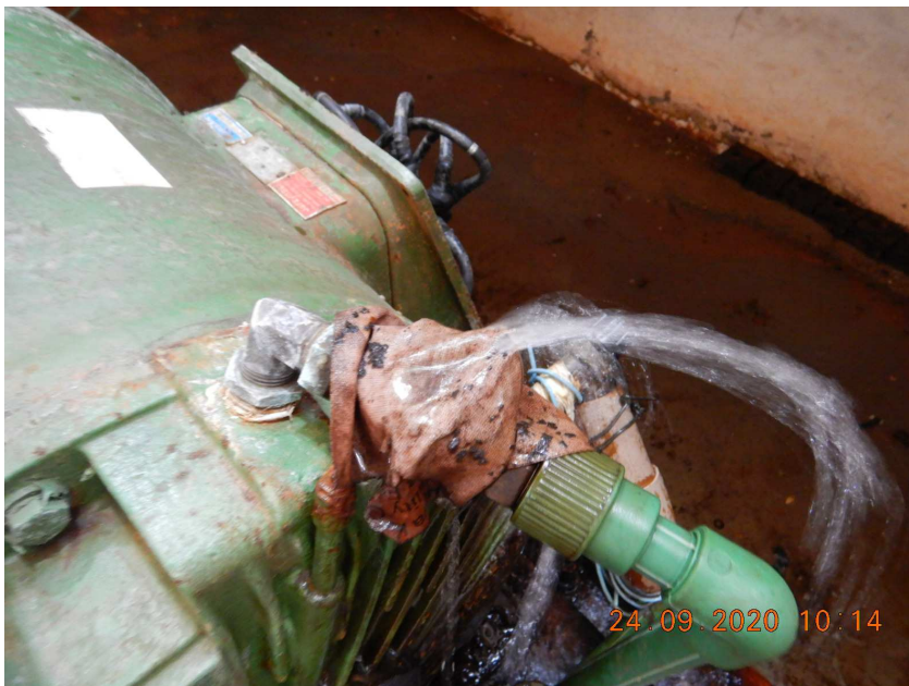
Figura 52: Vazamento em um dos CMB da EAT 09
