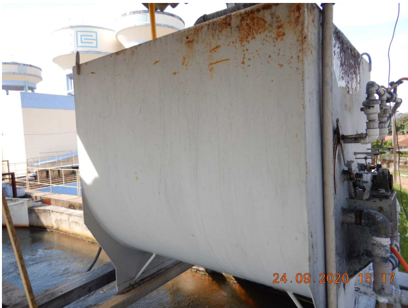
Figura 18: Dosador de caneca para dosagem de carvão ativado
