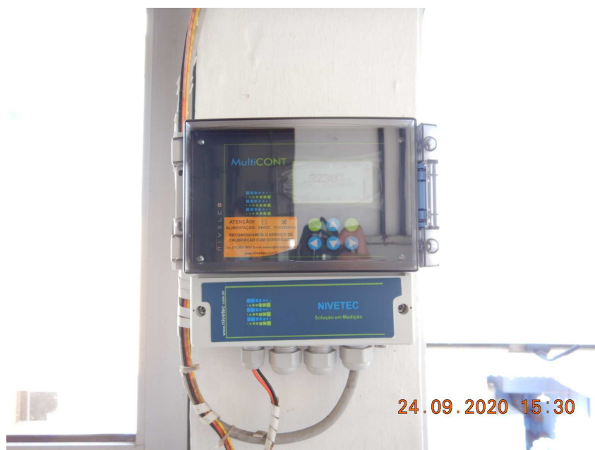
Figura 20: Secundário do Macromedidor
