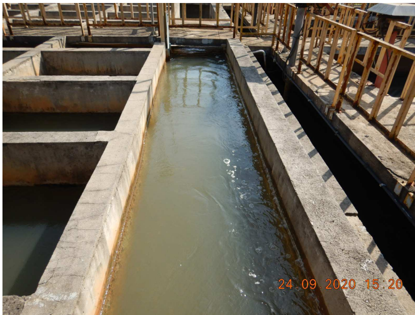
Figura 30: Sistema de floculação hidráulica
