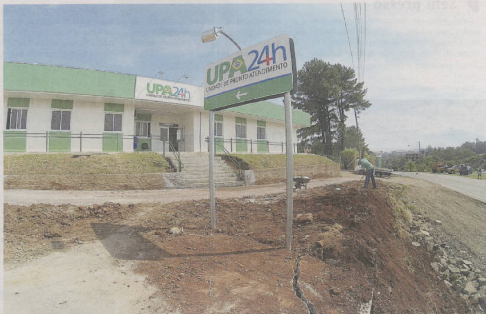
Mesmo após inaugurada, UPA de Lajeado segue com algumas obras inacabadas. Entre elas, a construção de uma rótula na ERS-413 para acesso de veículos e ambulâncias
