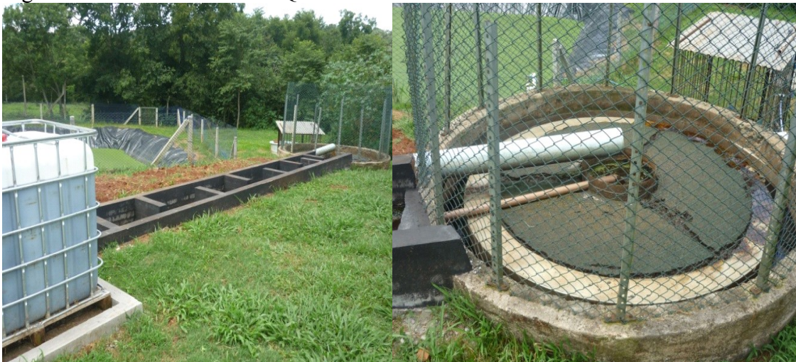
Figura 24: Tratamento Físico- Químico
