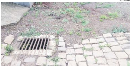
PROBLEMA: no bairro, bueiro está em desnível com a rua
