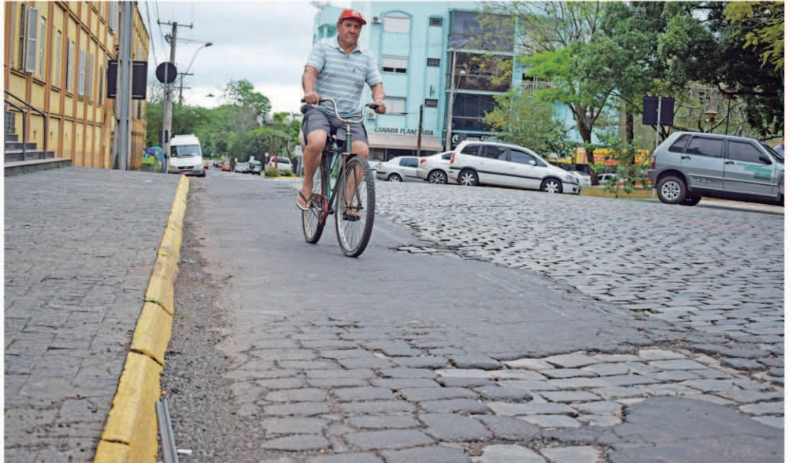
Pintura apagada, sujeira e falta de conservação são problemas registrados nos 21,5 quilômetros de ciclofaixas em Lajeado.
