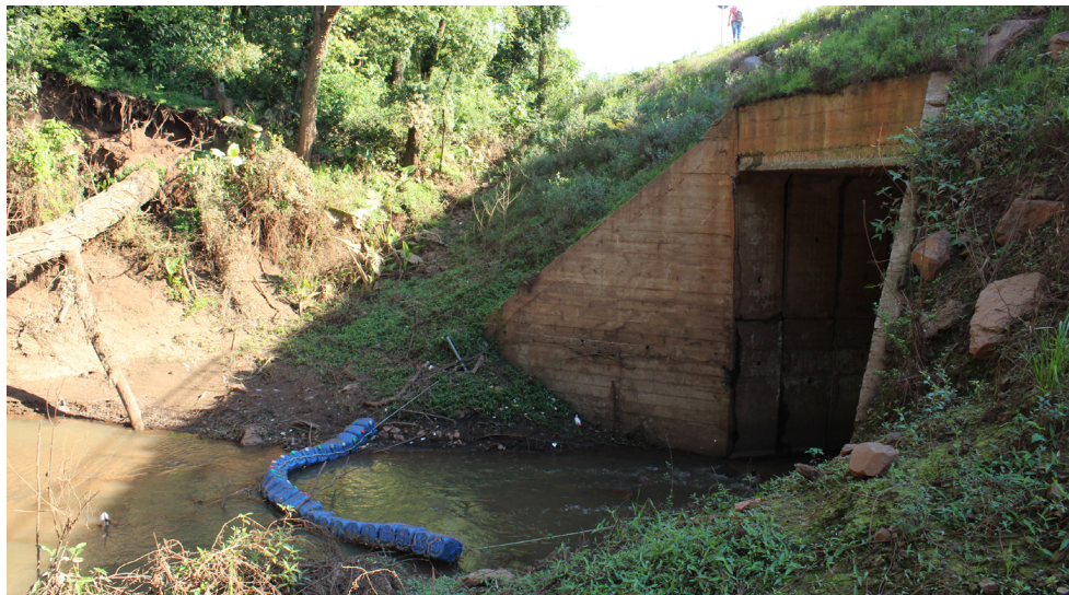
Ecobarreira instalada no arroio Engenho evita que resíduos cheguem ao rio
