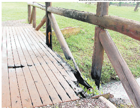
DANO: vândalos atearam fogo na estrutura da ponte
