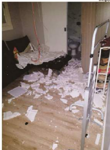
LAJEADO: no Bairro Americano, o forro de um apartamento cedeu durante o temporal
