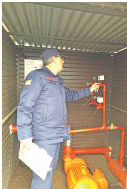
BOMBA HIDRÁULICA: necessária à emissão do certificado de regularidade do PPCI
