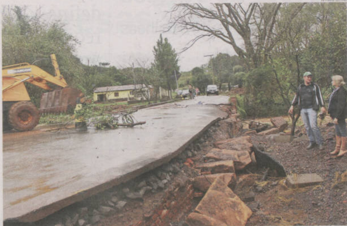
Enxurrada causou interrupções no trânsito em Vila Santo Antônio, na cidade de Mato Leitão
