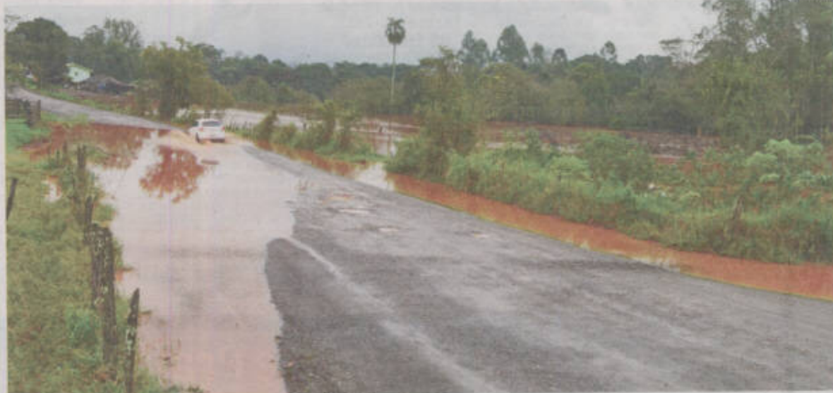
Alagamentos causaram transtornos na localidade de São Jacó, em Estrela
