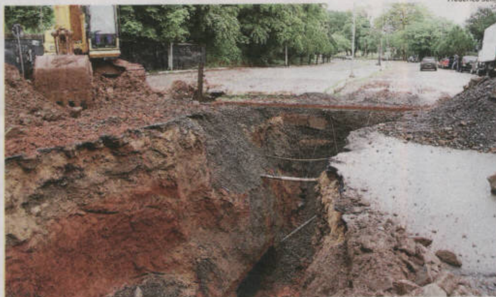
Parte da parede da galeria de canalização do Arroio Engenho caiu em consequência da erosão
