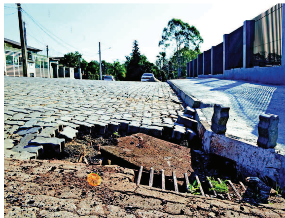
Bueiro danificado em esquina preocupa moradores na rua Nonoai
