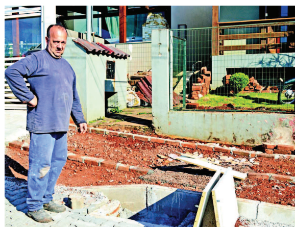
Jairo Ferreira tapou por conta buracos resultantes da obra no terreno de casa
