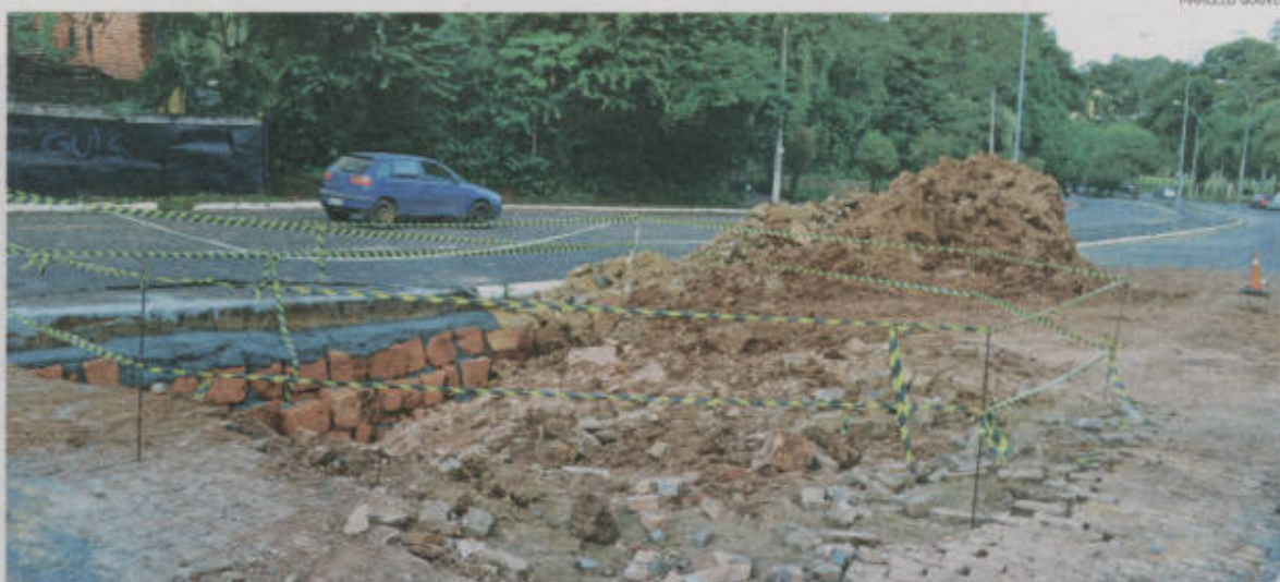
Problemas gerados por infiltrações tornam sustentação da galeria instável. Secretário indica risco de desmoronamento
