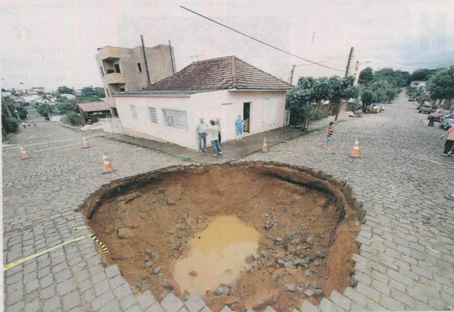
Cratera está aumentando de tamanho e assusta moradores do Bairro São Cristóvão
