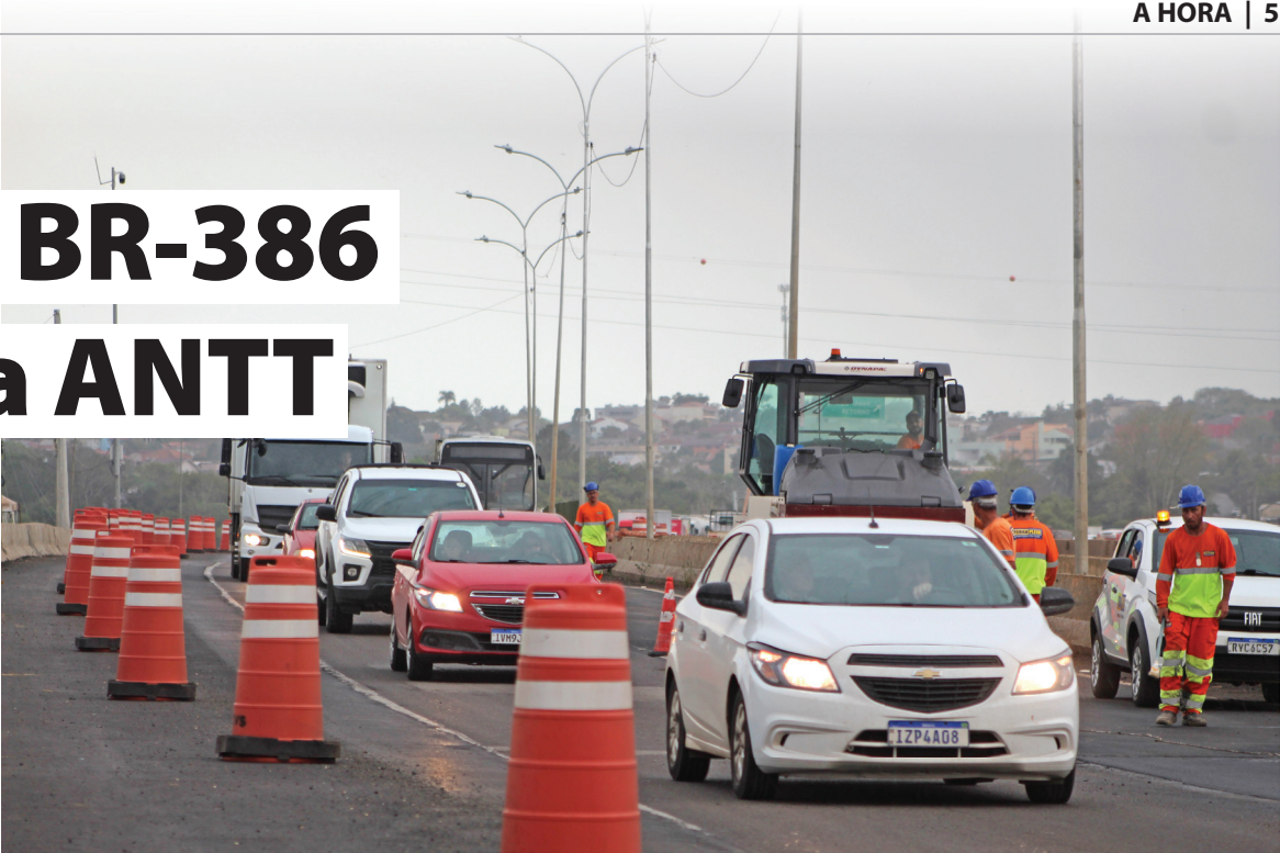
Congestionamentos têm sido frequentes na 386 por conta de intervenções nas pontes
