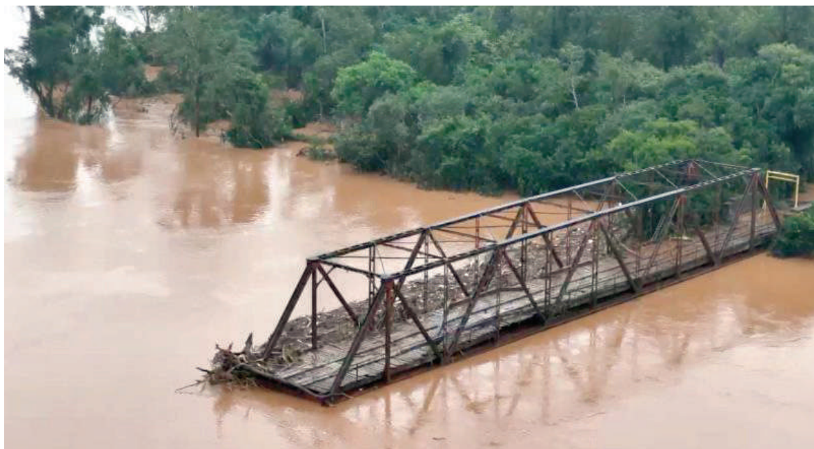
Estrutura da Ponte de Ferro que restou deve servir para a reconstrução
