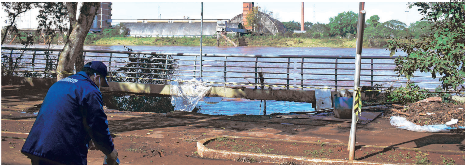
Belvedere às margens do Rio Taquari foi interditado depois de parte da estrutura de concreto ceder na manhã de ontem. Município avalia prejuízos
