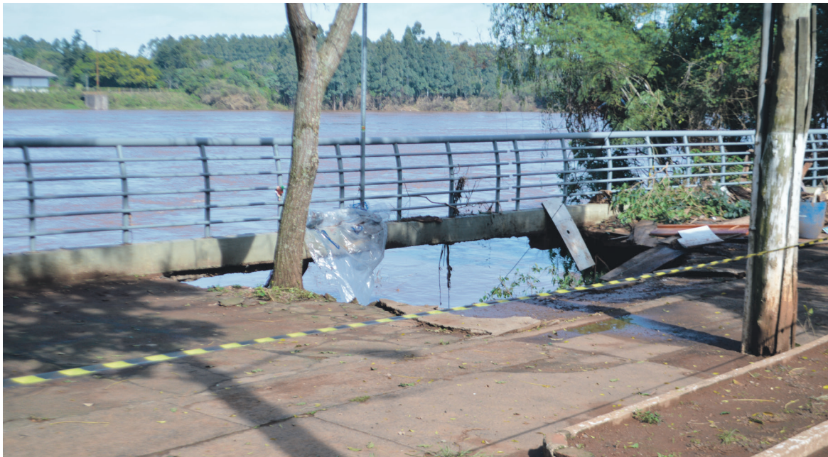
Belvedere desabou e causou estragos na Rua Oswaldo Aranha, em Lajeado
