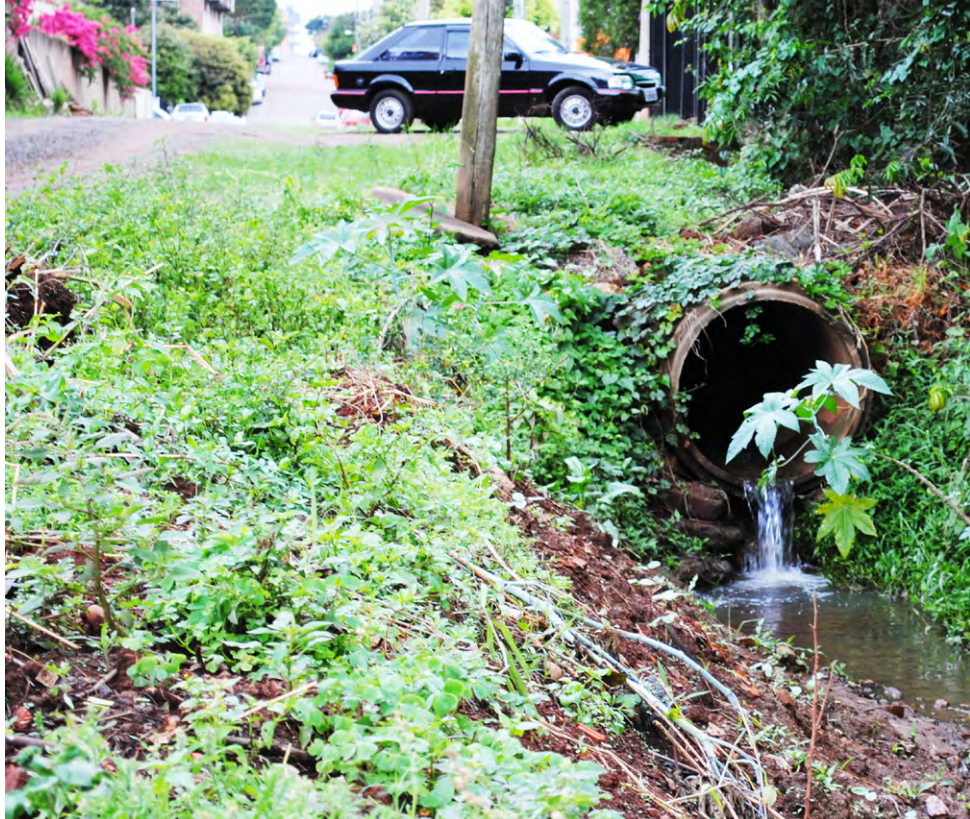
A FALTA DE TRATAMENTO DE ESGOTO É UM PROBLEMA CRÔNICO EM LAJEADO. DA ESTAÇÃO CONSTRUÍDA PELA CORSAN, HÁ APENAS 340 CASAS LIGADAS AO SISTEMA
