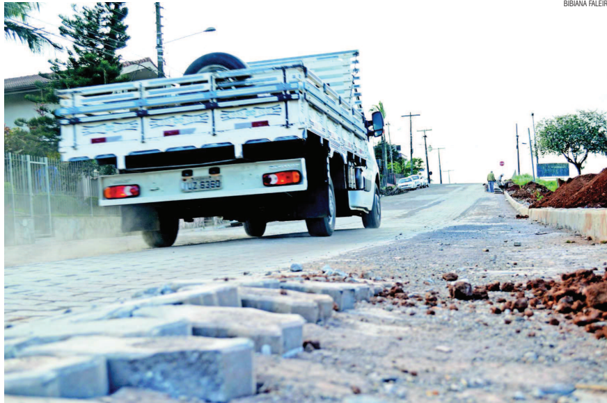
Justificativa do governo para problemas na obra é a passagem de veículos pesados pela via recém pavimentada
