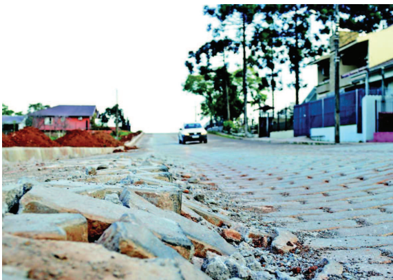
Desníveis e buracos são as principais reclamações de usuários
