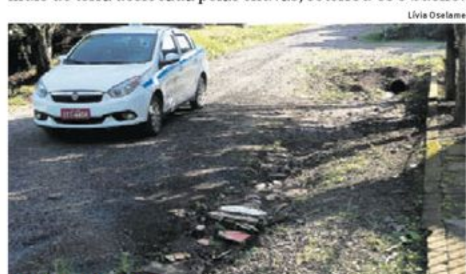
REIVINDICAÇÃO: bueiro não comporta todas as residências, causando inundações
