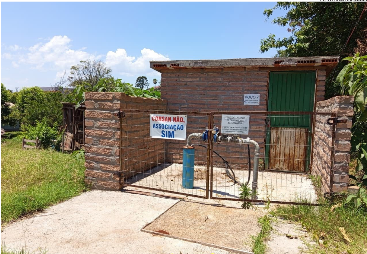
Comunidade é responsável pela manutenção de oito poços que abastecem cerca de 1,5 mil economias
