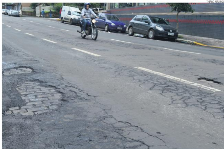
Uma das vias mais deterioradas, a av. Benjamin Constant faz parte de projeto de recapeamento com recursos da União
