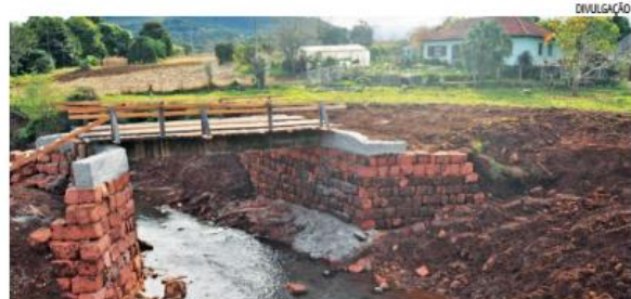
Estrutura foi construída após antigo pontilhão ser destruído por enxurrada
