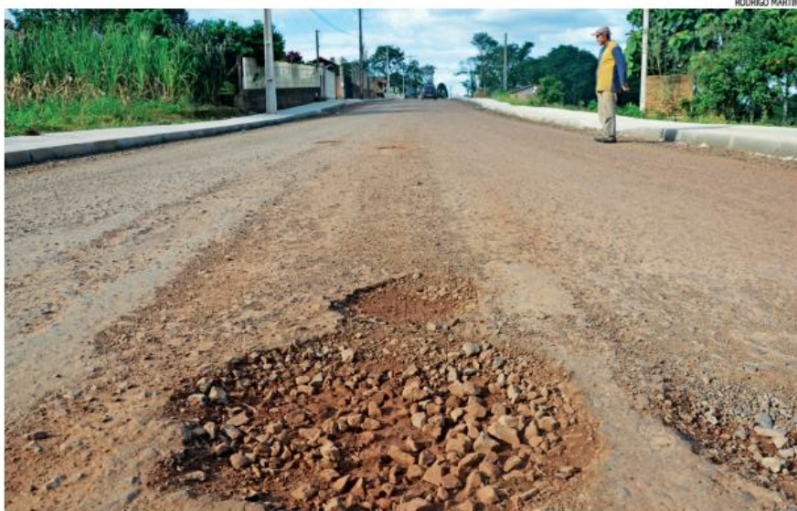
Na rua Pedro Petry, no bairro Universitário, falta aplicar asfalto e finalizar calçadas. Buracos aparecem com a paralisação
