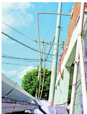
Canos sob telhado foram improvisados
