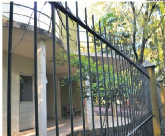
Ladrões arrombaram uma porta de alumínio localizada nos fundos do prédio
