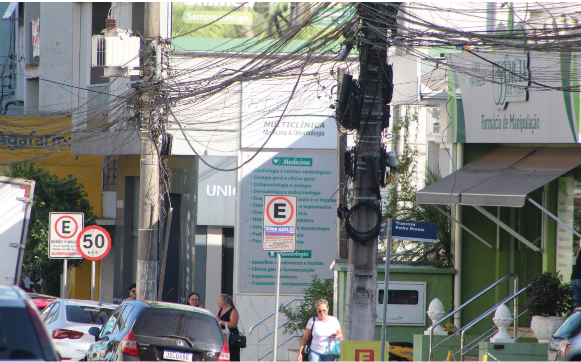
Moradores alertam sobre condição de fios nos postes e os riscos para pedestres e motoristas
