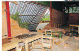
Em Mato Leitão, parte do ginásio caiu sobre a entrada principal
