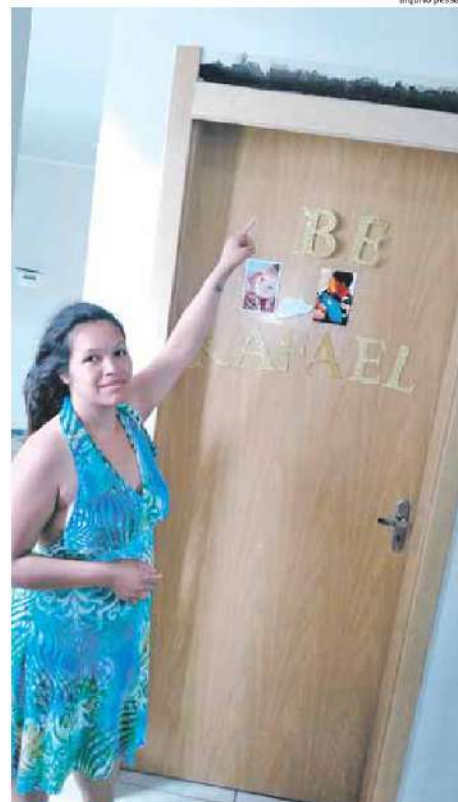
PREJUÍZO: infiltração danificou o marco de uma das portas da residência de Vera
