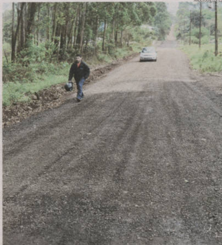
Restos de asfaltos foram colocados próximo da entrada de um frigorífico
