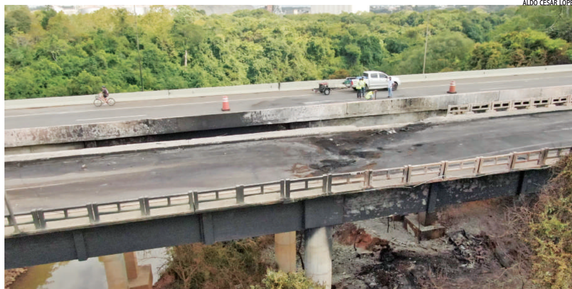
Acidente no dia 13 de março resultou na morte do condutor e na limitação do fluxo sobre a BR-386. Trecho menos atingido será liberado total na próxima terça-feira
