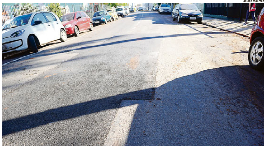
REMENDO: a Rua Olavo Bilac é uma das vias do município que ficaram com desnível depois de obras
