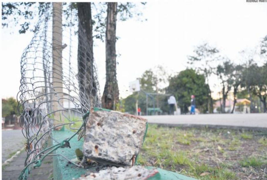
Na praça do bairro Hidráulica, são pelo menos quatro postes metálicos iluminando a área de esportes
