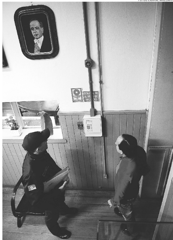
Central de alarme , uma das exigências do Corpo de Bombeiros para obtenção do PPCI, foi instalada no prédio
