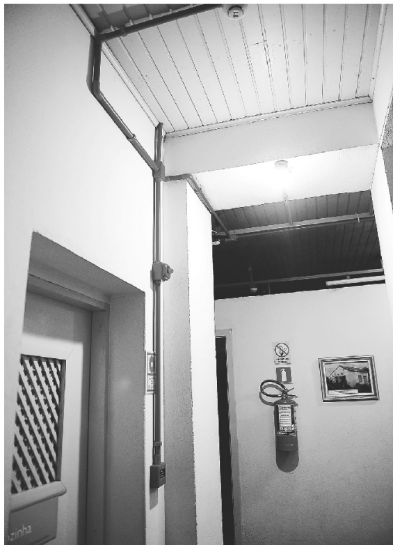
Detetores de fumaça foram instalados na maioria das salas do prédio que abriga o museu
