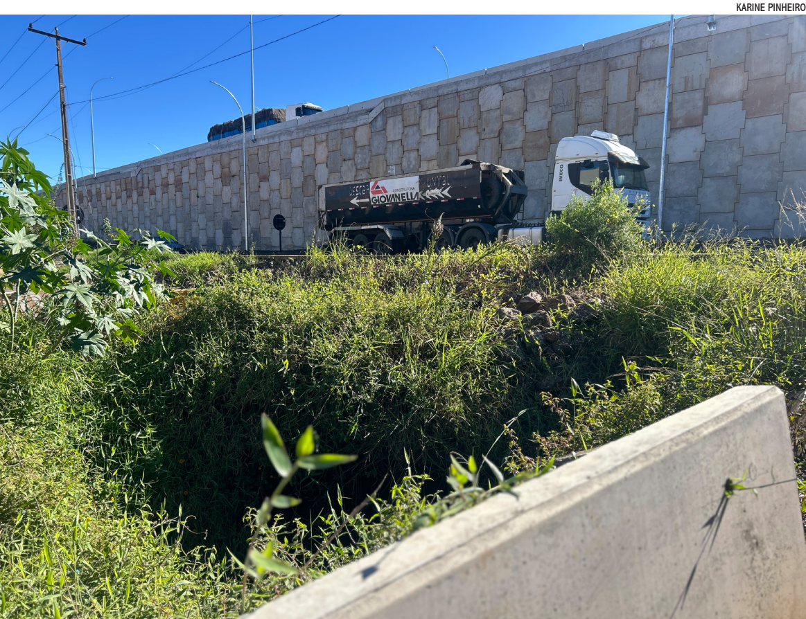
Bueiro aberto próximo à via lateral causa preocupação à comunidade local e gera risco aos condutores
