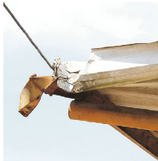
ESTRAGO: a parada na Rua Doutor Parobé, além de estar com a cobertura danificada, possui um fio de telefone enroscado
