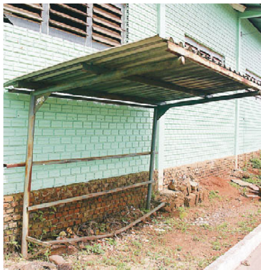
DESTRUIÇÃO: o que sobrou da parada do Bairro Centenário foi o teto e as barras com ferrugem
