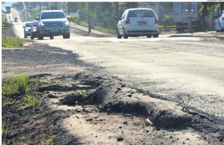
Daer não indica data para iniciar serviços de recuperação da pista. Comunidade também cobra redutores
