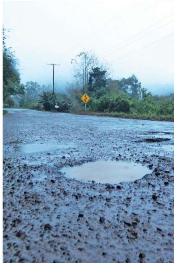
Condições da ERS-423 pioraram ao longo da semana devido à chuva
