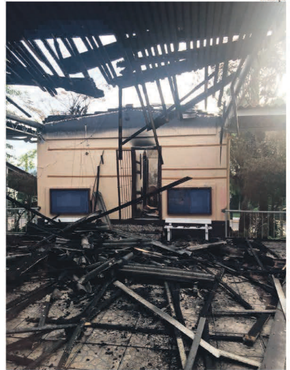
Secretaria foi consumida pelo incêndio, sobrou apenas as paredes de concreto
