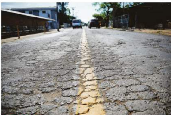
PROBLEMAS: a rua apresenta desgaste asfáltico e buracos
